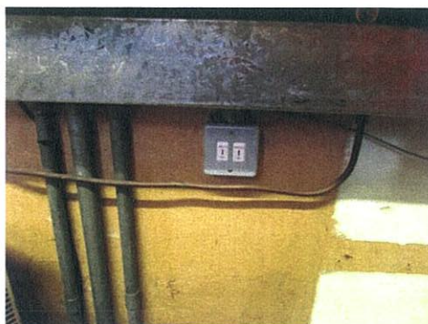
Galvanised Steel Conduit
